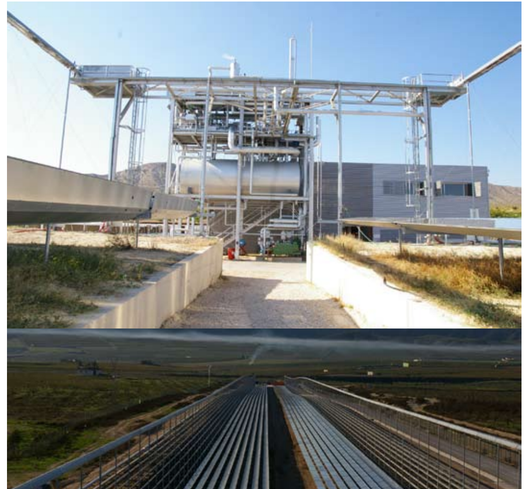
Image: centrale thermique solaire PE1
